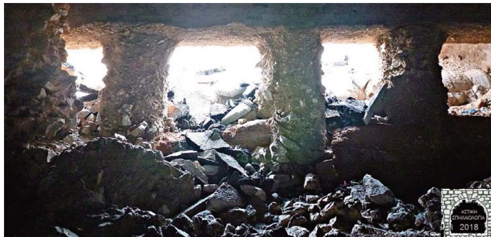
Ο Ιλισός έχει δώσει σημαντικά δείγματα διάβρωσης και καθιζήσεων εδώ και έξι χρόνια (Πηγή φωτό: Αστική Σπηλαιολογία)
