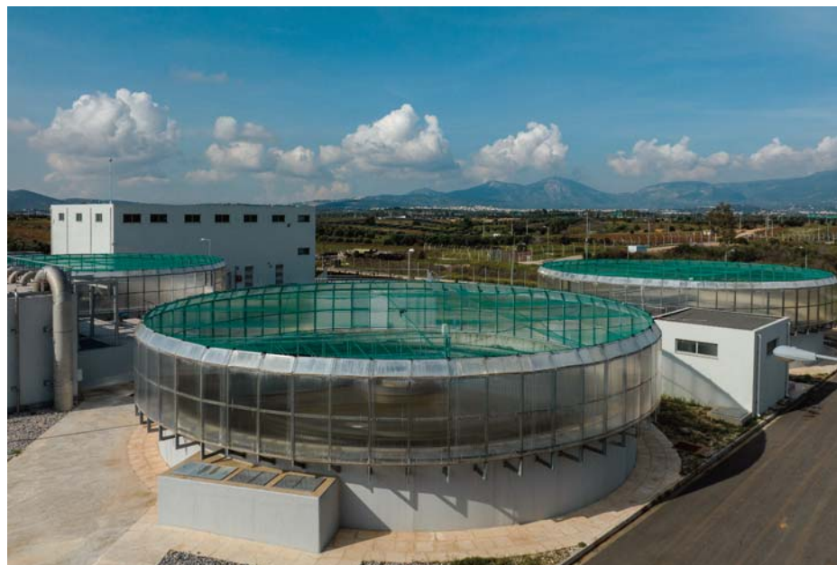
Δεξαμενές πρωτοβάθμιας καθίζησης
